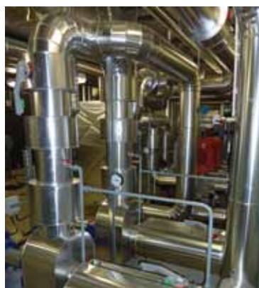
CAFRILOR ITIB - Isolation de 3kms de tuyaux - partie climatisation de l'extension de Minatec à Grenoble
